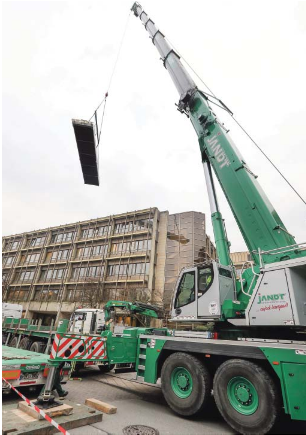
In luftiger Höhe: Der Kran hebt den 2.250 Kilogramm schweren Rückkühler auf das Dach des Neuen Rathauses an der Körnerstraße.
