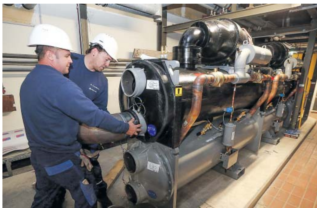
Kältemaschine: (v. l.) Alexander Fengler und Maik Scheidhauer schließen im Keller des Klinikums ein Rohr an, durch das kaltes Wasser gepumpt wird. FOTO: WOLFGANG RUDOLF
